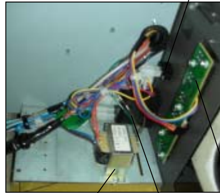
【Back side of control panel】
